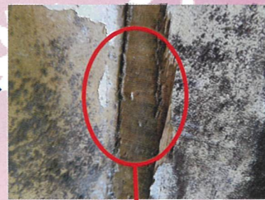
壁紙を剥がしてシロアリを確認
